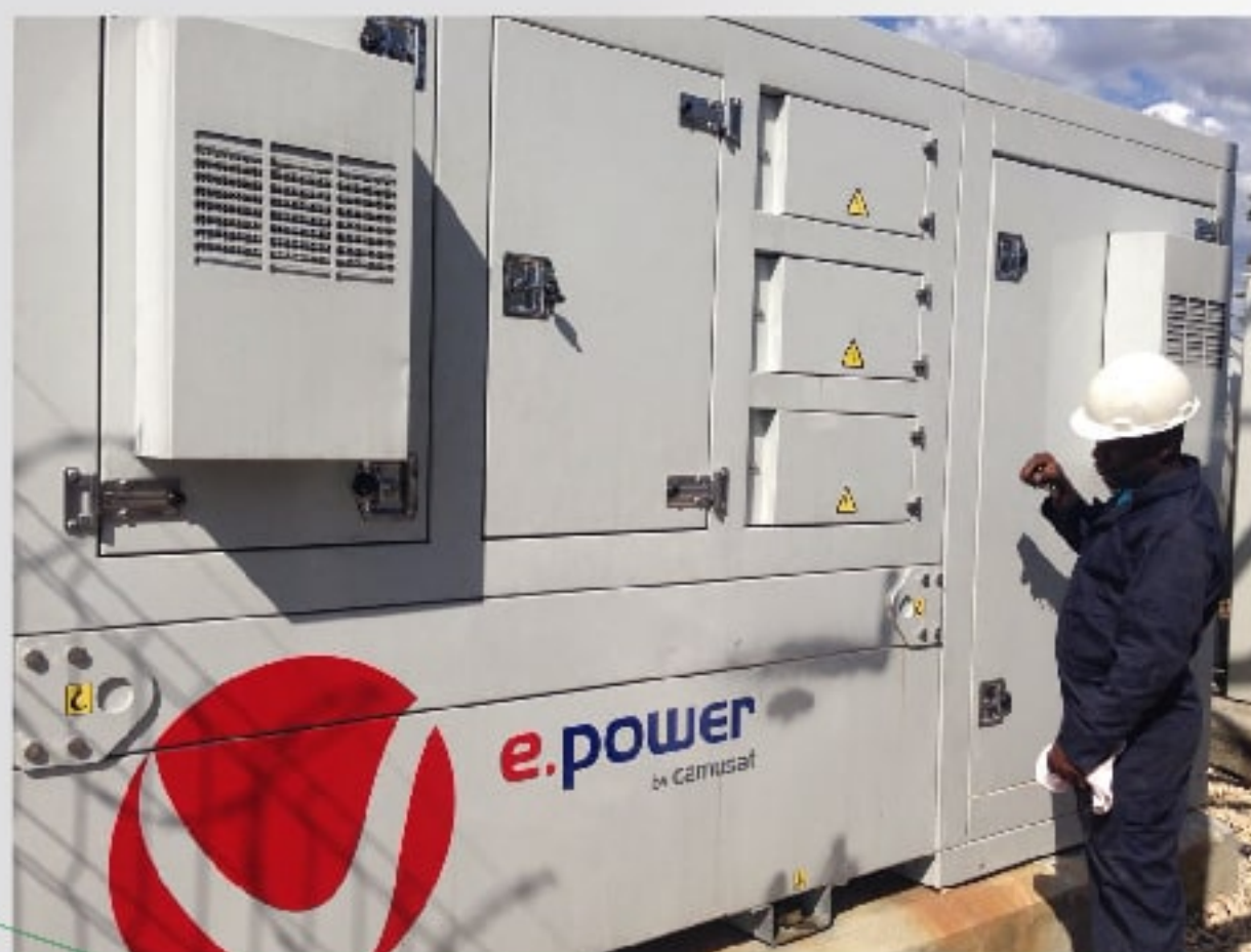
Solution e.power sur site
